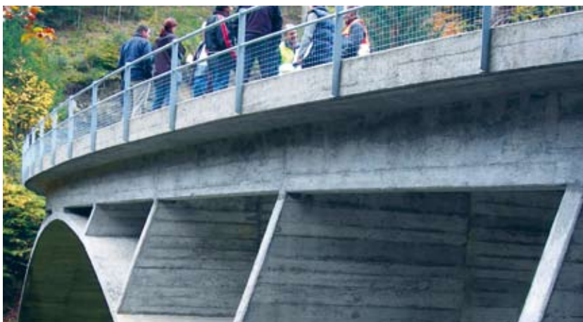
Brücke mit instand gesetztem Rohrgeländer, das nicht den heutigen Sicherheitsnormen entspricht. Das zusätzliche Drahtgitter im unteren Bereich bildet die Absturzsicherung für Personen. Zusammen mit dem Schrammbord ist in dieser Situation auch die Anprallsicherheit gewährleistet. Schwandbachbrücke von Robert Maillart bei Hinterfultigen BE (EPFL/Eugen Brühwiler).
