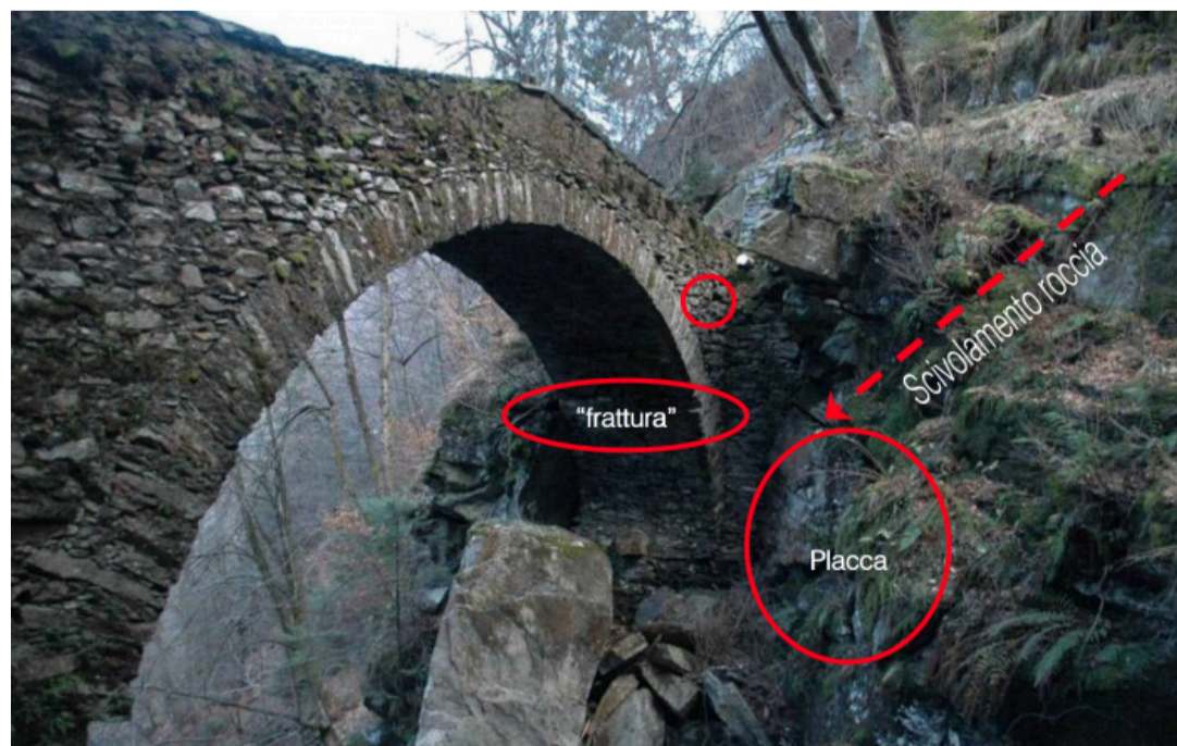
Ein sorgfältige Aufnahme des Schadensbildes war die Voraussetzung für eine erfolgreiche Instandsetzung. (Foto: Lucchini – Mariotta e Associati SA)
