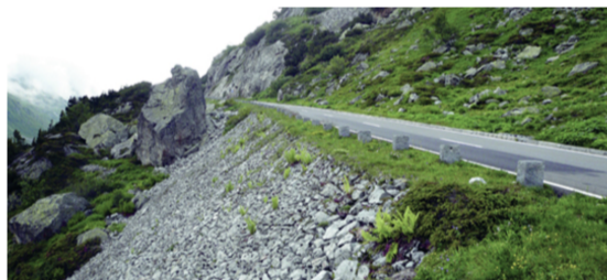
Ill. 5 : Route du col du Susten avec des pierres bordières et le ballast (photo : G. Schneider)
