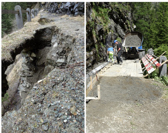
Ill. 2 : Partie effondrée du chemin (photo : O. Hugentobler, association « alte Averserstrasse ») Ill. 3 : Consolidation avec une passerelle et construction de la rigole d'écoulement (photo : O. Hugentobler, association alte Averserstrasse)
