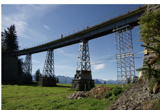
Ill. 4 : Consolidation provisoire du pont d'Unterstetten. Il constitue avec les ponts de Rothenflue et Schild un ensemble d'anciens ponts de la ligne ferroviaire Rigi Kaltbad–Unterstetten–Rigi Scheidegg (photo : F. Bieri, Basler & Hofmann)
