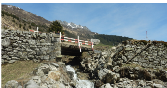
Ill. 1 : Contrefort endommagé (à droite) avec pont de secours sur le Seebach (photo A. Arnold, service de l'aménagement du territoire du canton d'Uri)
