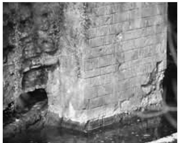
Abb. 1: Abbröckelnde Kalksteinquader am Fuss des westlichen Uferpfeilers der mittelalterlichen «Steinenbrugg» bei Liestal zeigen unmissverständlich, wie nötig sie eine Sanierung hat (ED).
