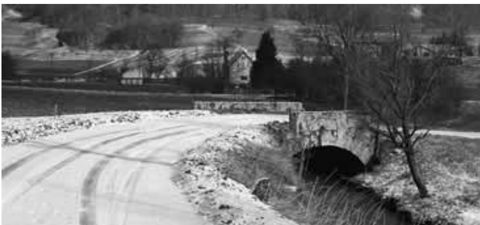
Abb. 2 (oben): Überwuchert und vom Wurzelwerk der Büsche angegriffen ist auch die sorgfältig gemauerte «Gorisenbrücke» bei Reigoldswil. Nicht sichtbar sind die Eingriffe in das Widerlager links (CD).
