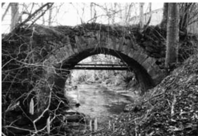
Abb.3: Die «Sagelibrücke» an der Alten Ruswiler Landstrasse, eine der wenigen erhaltenen Steinbrücken aus der Zeit der Alten Landstrassen, bedarf einer sachgerechten Sanierung.
