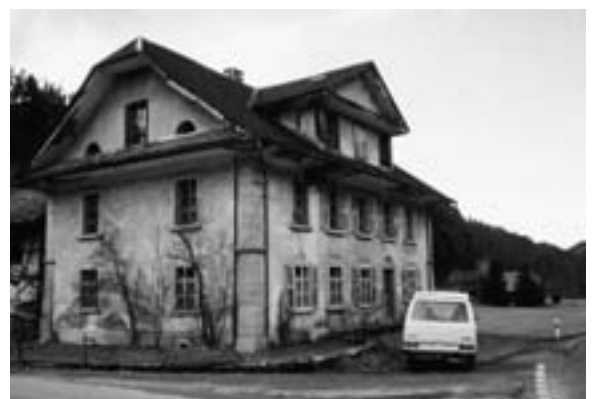
Abb. 14 und 15: Darstellung aus dem Plansatz von 1833 zum Neubau der Zollstelle Wissenbach auf der Grenze gegen Bern (oben). Ausgeführt wurde eine etwas reduzierte Form (unten). Der Bau wird heute nicht mehr angemessen genutzt und ist so vom Verfall bedroht.
