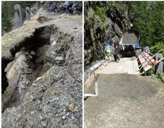
Immagine 2: Dettaglio della via crollata. (Foto: O. Hugentobler, Associazione "alte Averserstrasse")
