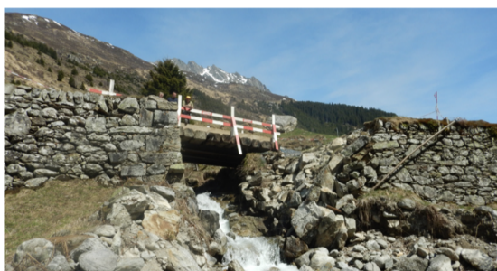
Immagine 1: Spalla danneggiata (a destra) con la passerella di emergenza sul Seebach (Foto: A. Arnold, Ufficio sviluppo territoriale Uri)
