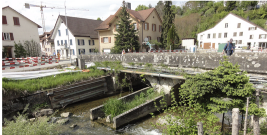
Immagine 7: Lavori di costruzione presso il ponte Surbrücke a Döttingen AG . (Foto: S. Zala, Basler & Hofmann)
