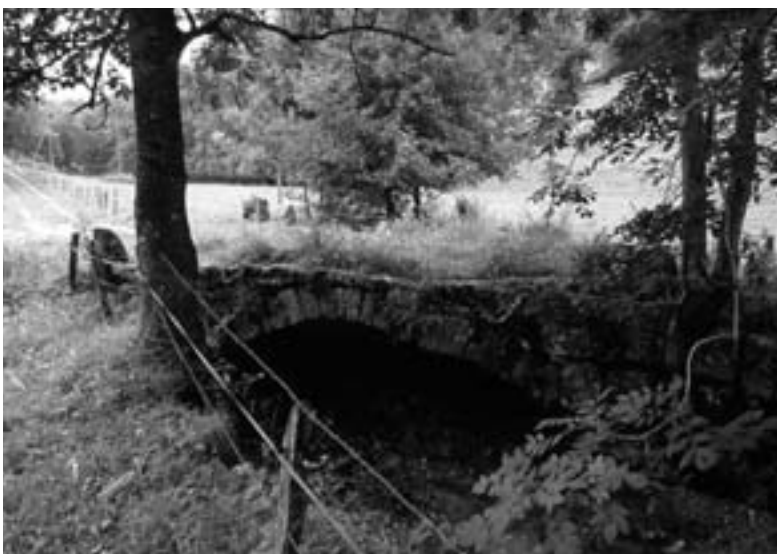
Abb. 6: Die Brücke über den Chastelbach zwischen Himmelried und Steffen besitzt wie viele ländliche Kleinbrücken keine Brüstung, sondern nur vier Prellsteine an den Auffahrten. Das Bruchsteingewölbe hat sich etwas gesenkt und ist renovationsbedürftig (CD).
