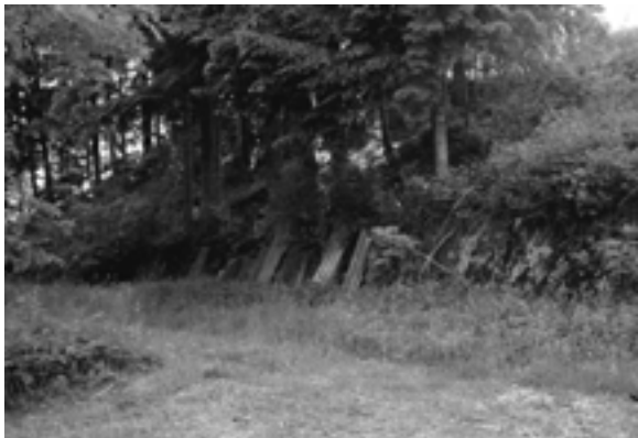
Abb. 14 (oben): Eine frühe Betonkonstruktion aus dem 20. Jahrhundert findet sich am Stoss. Dort sicherte bis zum Hangrutsch von 1930 eine massive Betonmauer ohne Armierung den Hang. Sie wurde wohl nach 1900 angelegt. Da sie kaum Entwässerungsöffnungen aufweist, erhebt sich der Verdacht, dass diese Mauer den Hangrutsch durch Wasserstau mit verursacht haben könnte. (T. Specker, 2006)
