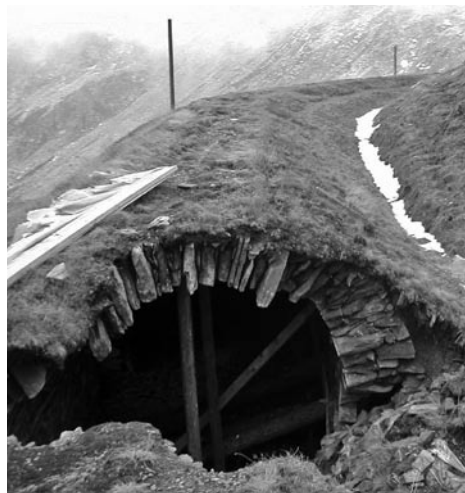
Fig. 6 Le toit de la galerie du Splügen est effondré par endroits Photo : F. Bieri
