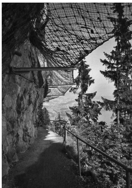
Fig. 3 Le Felsenweg dans le filet de protection Photo : H.-P. Kistler
