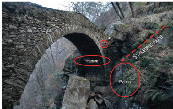
Il rilevamento scrupoloso dei danni è stato essenziale per il successo degli interventi di restauro. (Foto: Lucchini – Mariotta e Associati SA)
