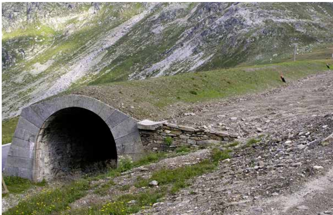
La galleria paravalanghe al Passo dello Spluga è l'unico manufatto di questo genere ancora intatto.
