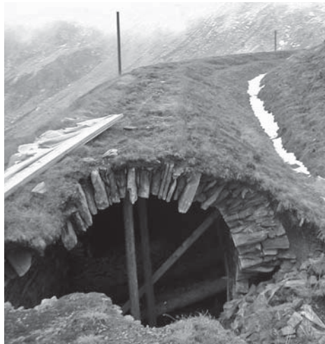
Abb.6 Das Dach der Splü- galerie ist stellenweise eingestürzt Foto: F. Bieri
